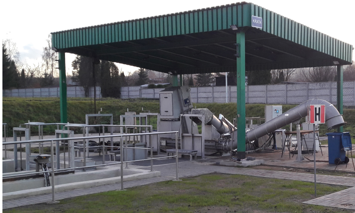
Rysunek 2.3: Oczyszczalnia ścieków.
